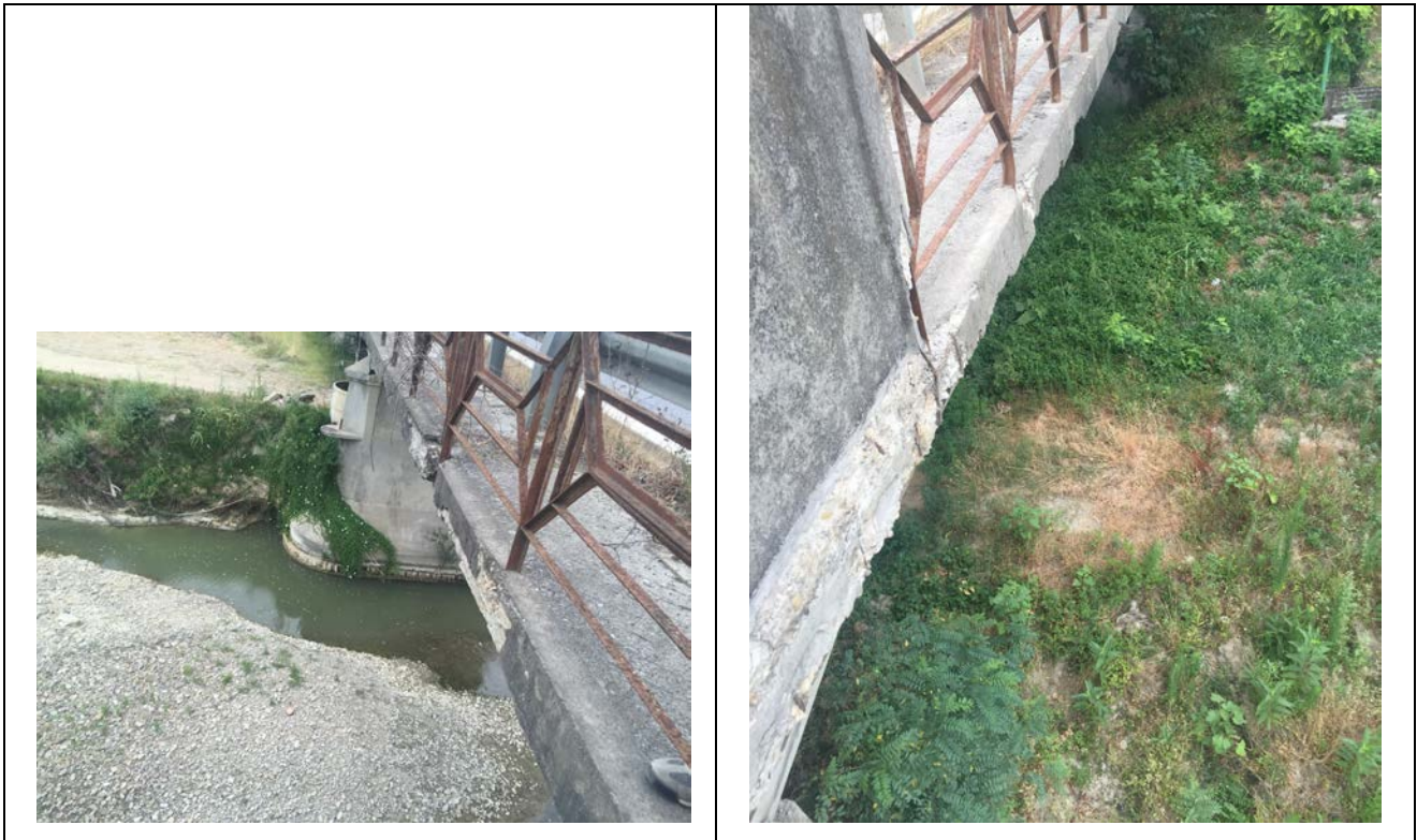
Degrado dello sbalzo di carreggiata (marciapiede) con evidenza di ferri esposti e cls ammalorato
