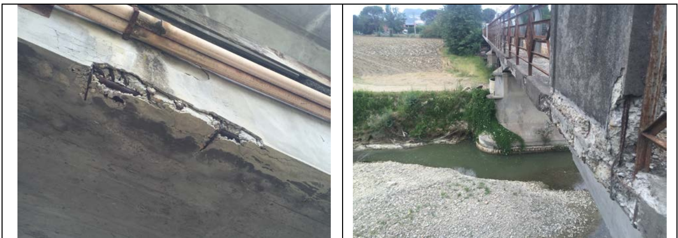
Presenza di ferri di armatura esposti (assenza di copriferro)
